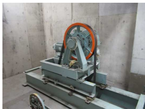
② ELV機械室 巻上機
