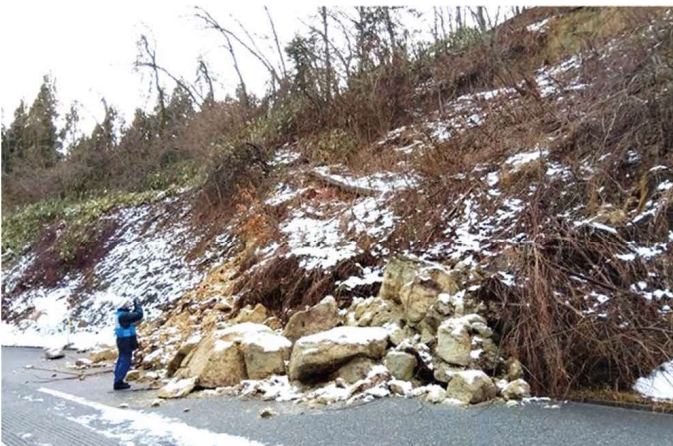
崩壊した道路法面(令和6年能登半島地震)
