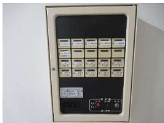
図5 第2試験研究棟（副受信機）
