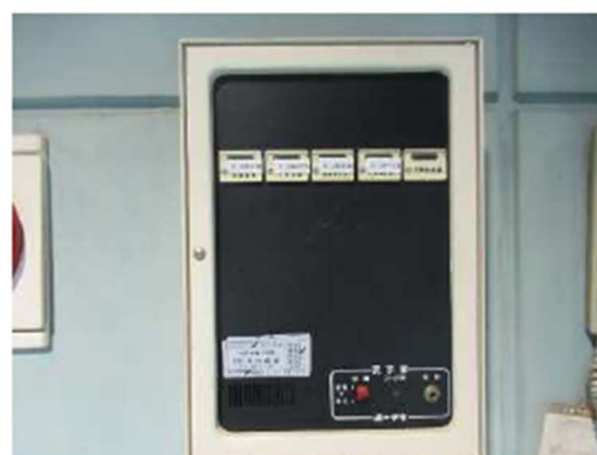
図6 第3試験研究棟（副受信機）
