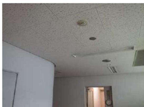
図3 事務庁舎棟（感知器）
