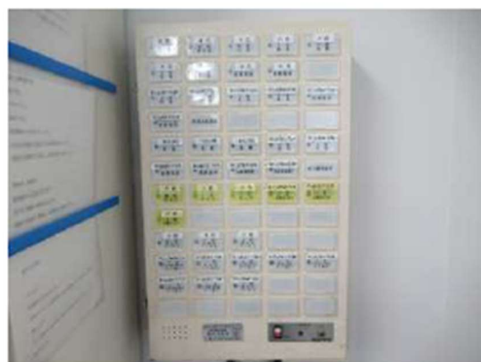
図2 事務庁舎棟（副受信機）
