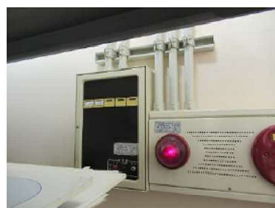
図4 第1試験研究棟（副受信機）
