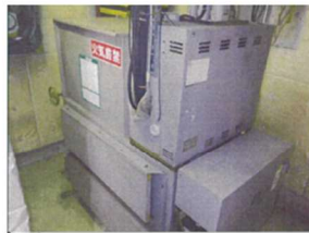
① 既存油圧エレベーター機械室
