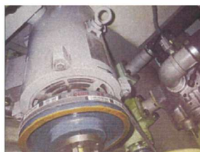
② 既存エレベーター機械室 パワーユニット
