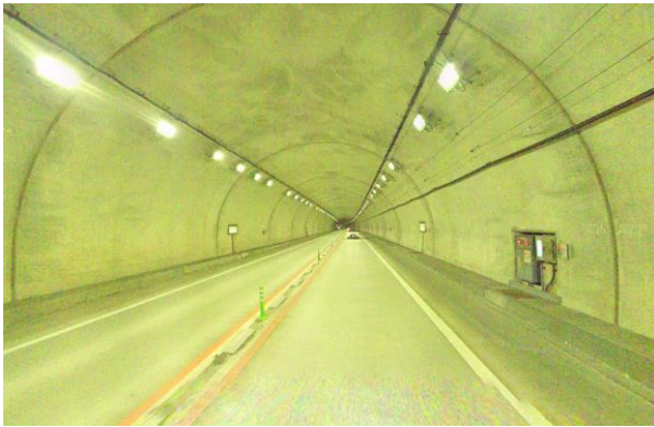
道路トンネル非常用装置
