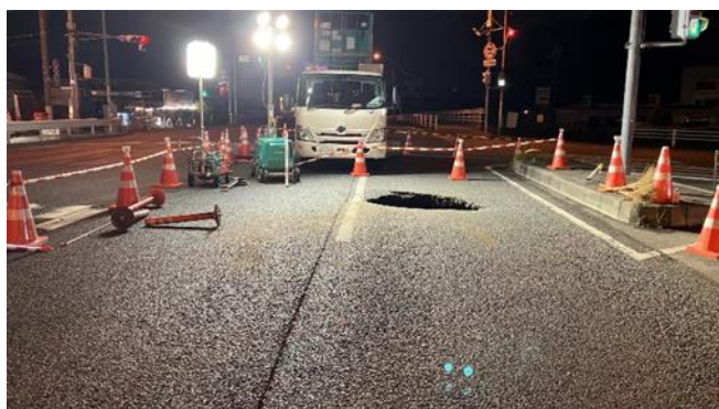
車道陥没状況
