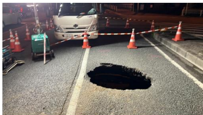
車道陥没状況
