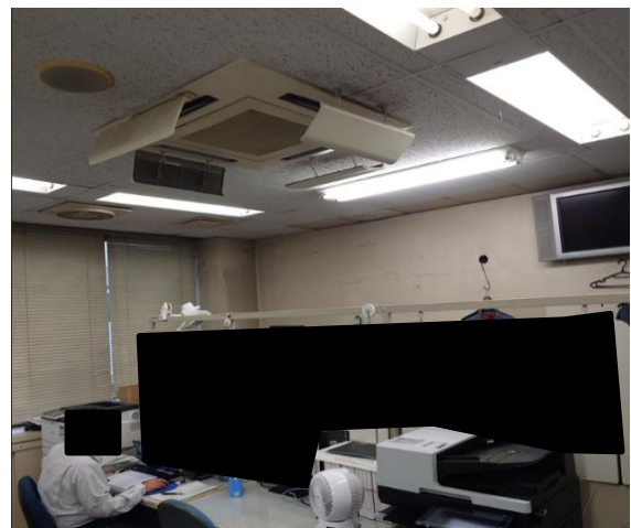
事務室室内機状況
