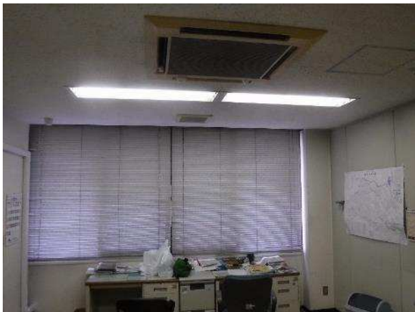
既設空調（屋内）
