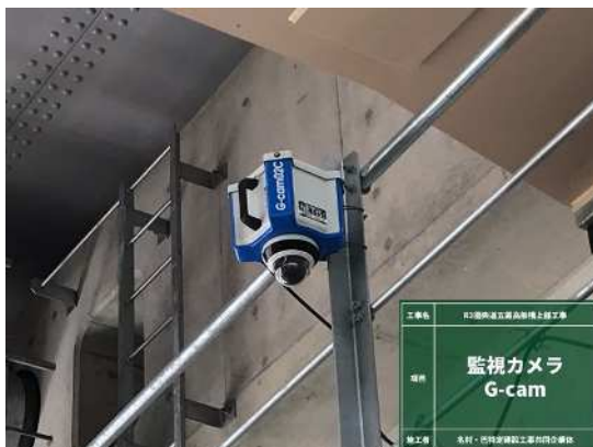
【通信一体型遠隔監視カメラによる監視状況】
