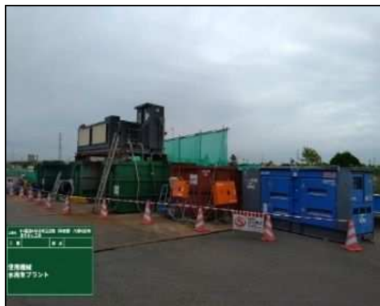
【水循環方式プラント設置状況】
