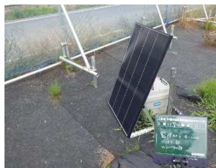
【ソーラーパネル・バッテリー設置状況】
