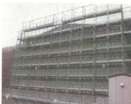
選択取水施設棟建設時状況 ※外部歩廊に足場を設置し施工
