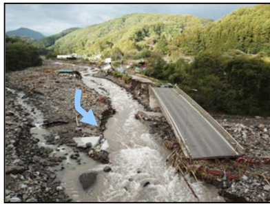
令和元年10月台風19号における 豪雨災害による国道144号被災状況
