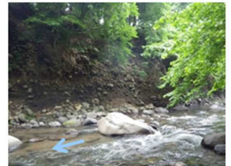
溪岸浸食状況
