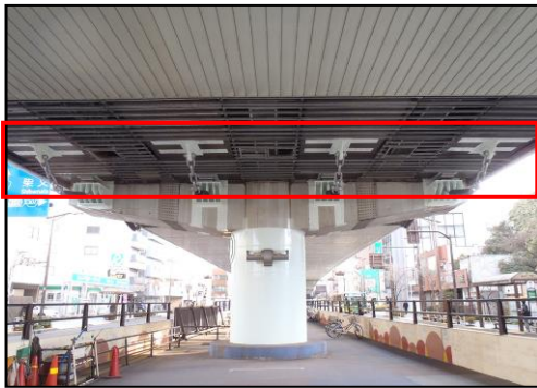
落橋防止装置
