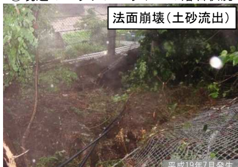
③局地的大雨による現道の法面崩壊状況
