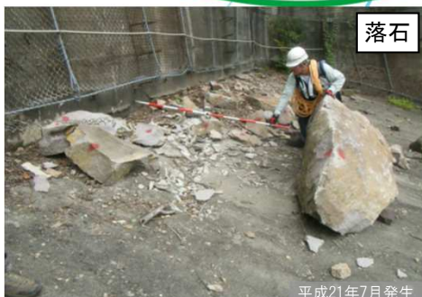
②現道のロックシェッドへの落石状況
