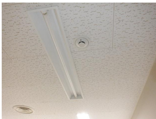
図3 庁舎(既存棟)感知器
