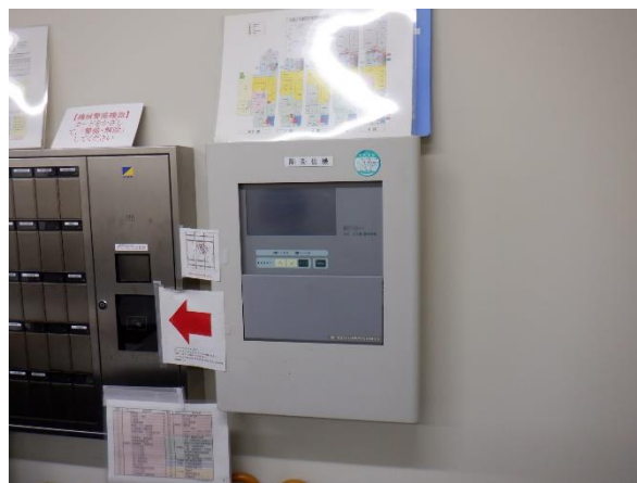
図2 庁舎(既存棟)副受信機
