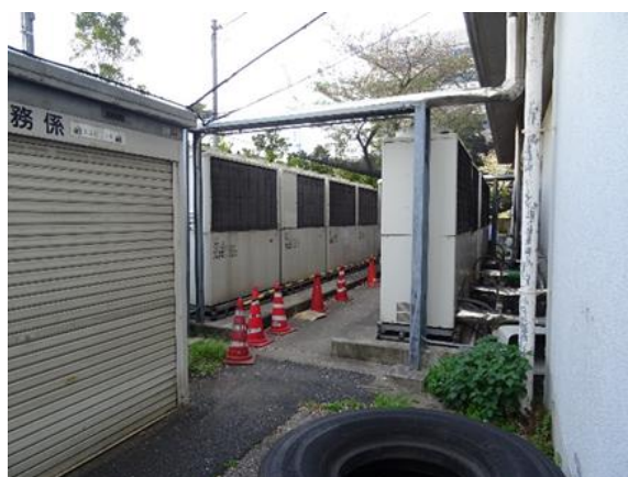
② GHP屋外機
