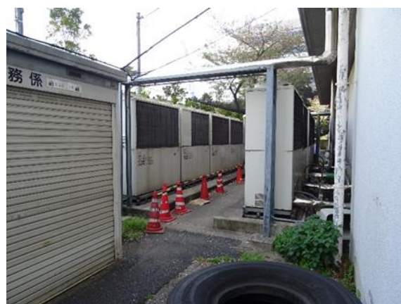
② GHP屋外機
