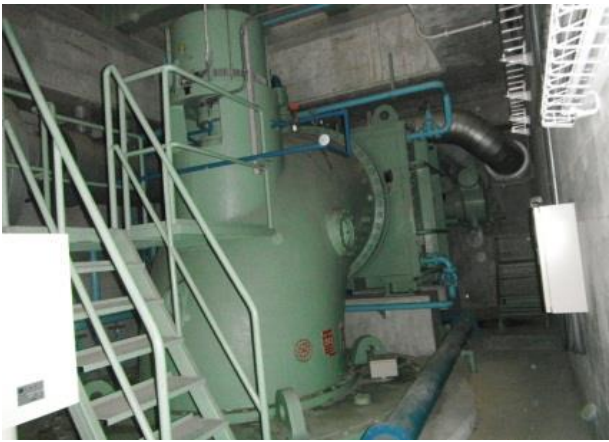
主ポンプ設備全景
