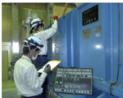
主ポンプ設備定期点検
