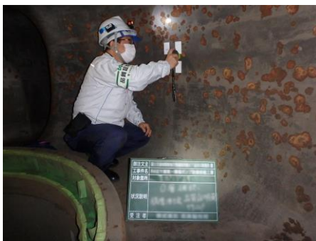
主ポンプ内部点検
