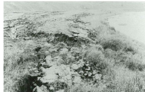
関東大震災後の護岸の状況
