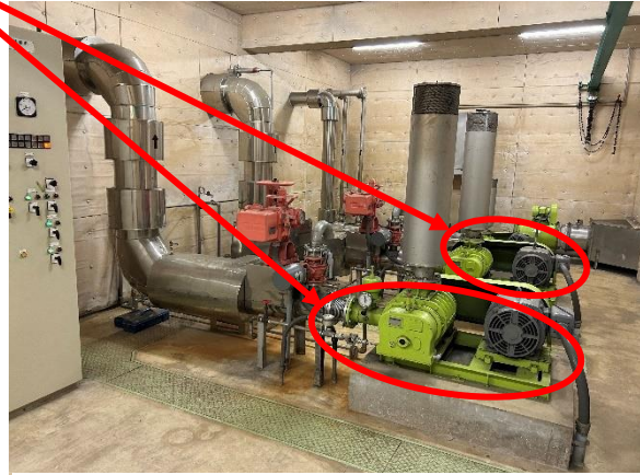
ブロー室（利根機場側）
