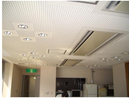
庁舎2階室内機状況
