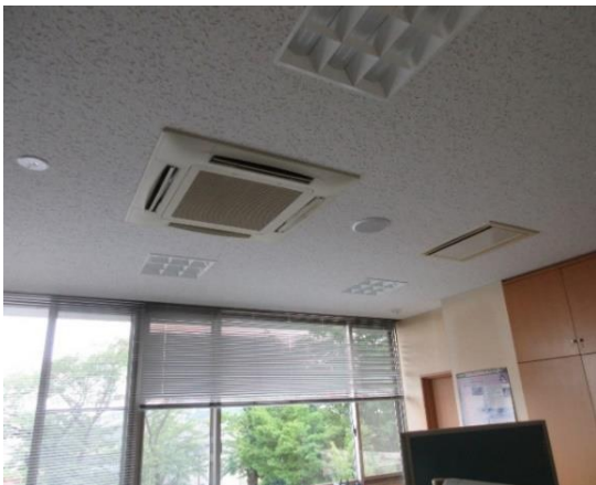
既設空調・換気設備（屋内）
