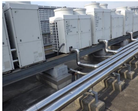
既設空調室外機（屋上）
