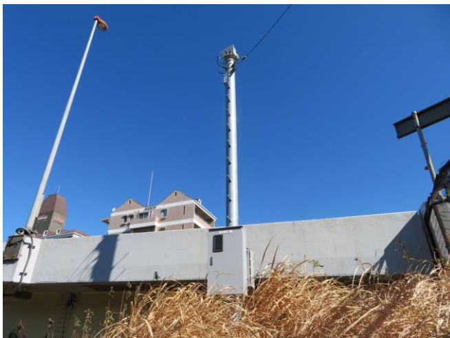
CCTV 設備（参考）
