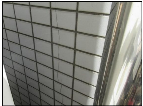
外壁タイルひび割れ状況
