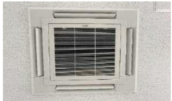
新設 天井設置空調機
