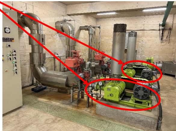
ブロー室（利根機場側）
