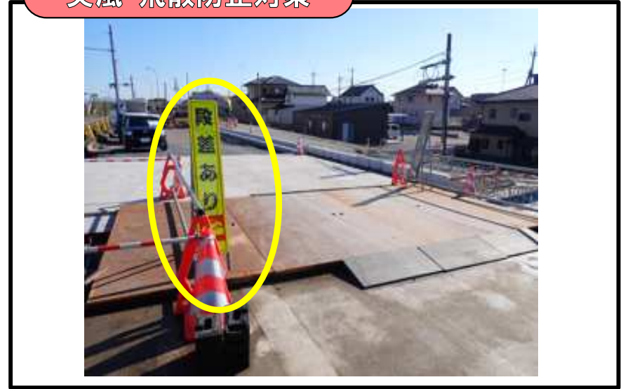
穴あきタイプの工事看板を採用
