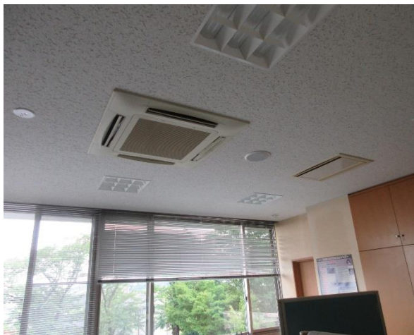
既設空調・換気設備 (屋内)
