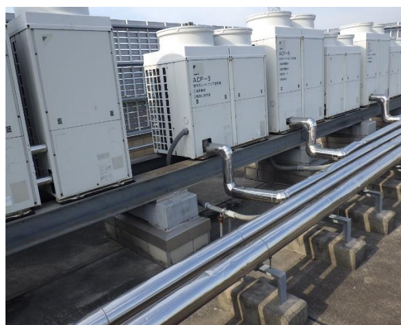
既設空調室外機 (屋上)
