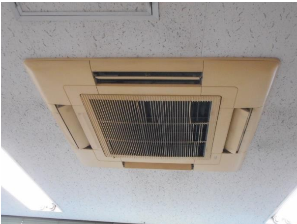
既設空調（屋内）
