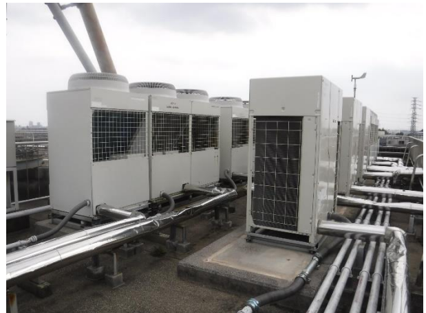
既設空調室外機（屋上）
