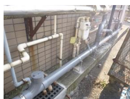
露出配管状況
