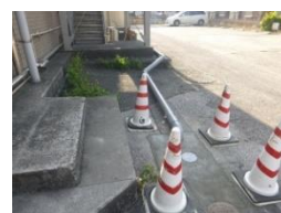
露出配管状況
