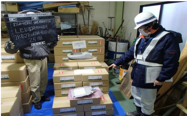
【使用LED照明器具】
