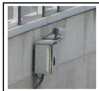
③監視装置 (カメラによる監視)
