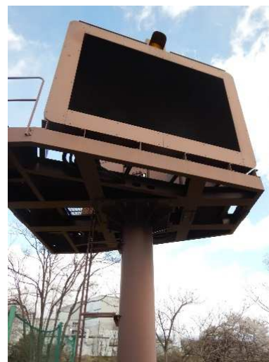
放流警報表示設備
