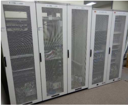
河川情報設備サーバ架
