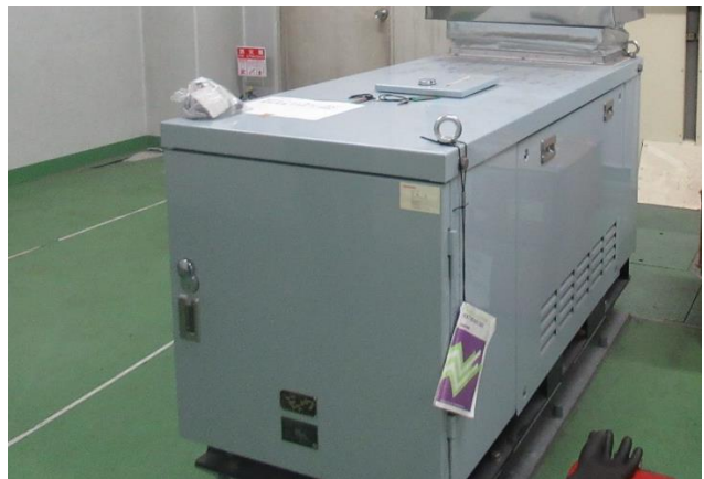
撤去予定の発電機
