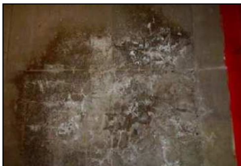
▲床版損傷状況 (ひび割れ)
