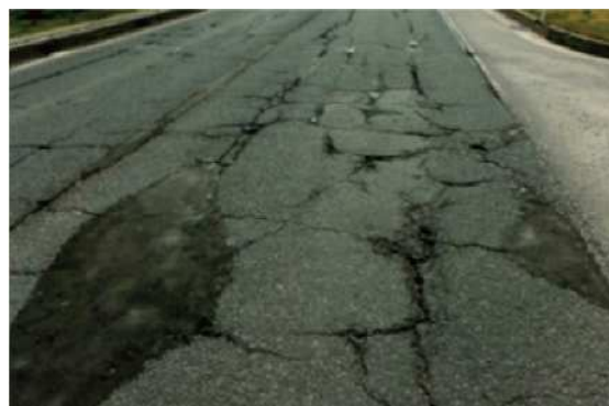
舗装の老朽化事例 （アスファルト舗装ひび割れ）
