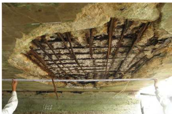
橋梁の老朽化事例 （床版鉄筋露出）
