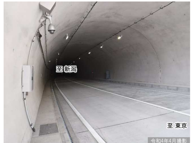
②新三国防災内部の状況
