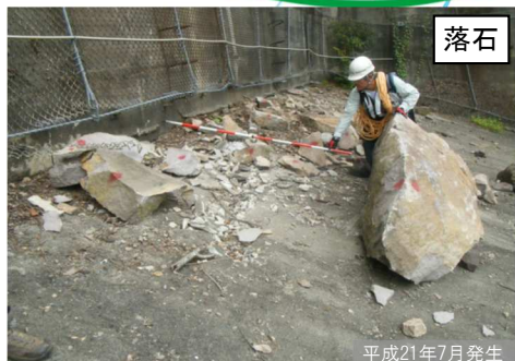
ロックシェッドへの落石状況
