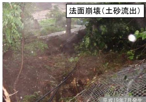
局地的大雨による法面崩壊状況
