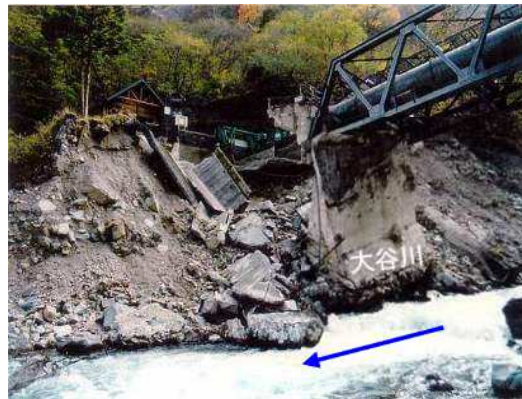
発電用取水施設の被災状況(H10)
