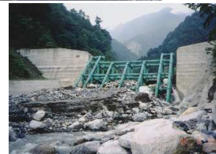
おおむかわとこがためぐん 砂防堰堤(透通型)：大瀬沢第二砂防堰堤
