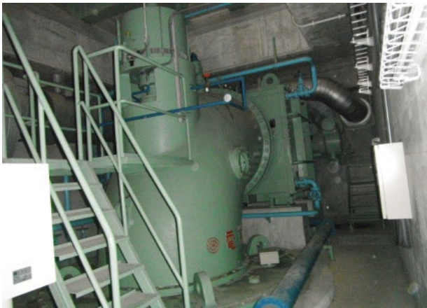
主ポンプ設備全景
