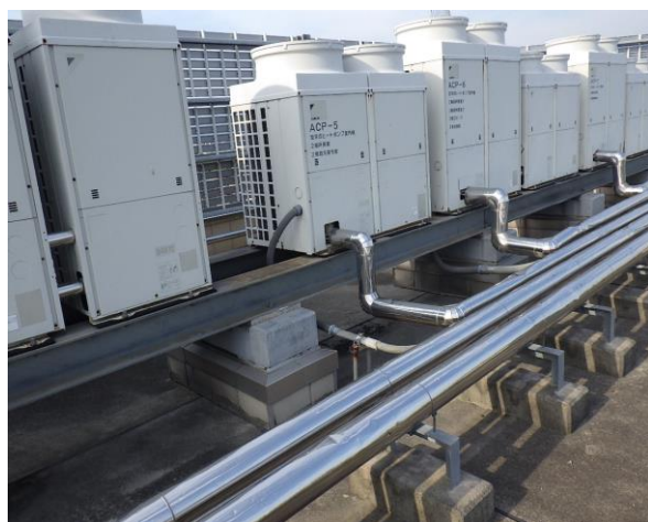
既設空調室外機(屋上)
