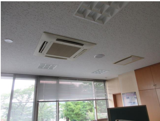
既設空調・換気設備(室内)
