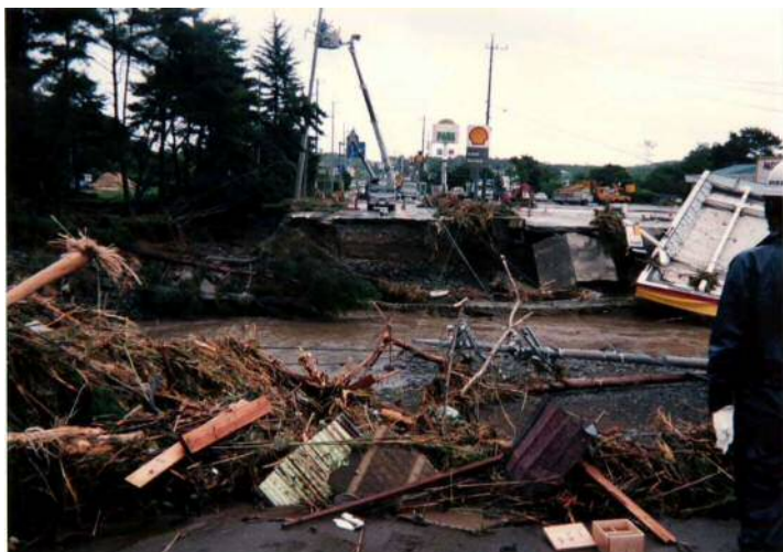
被災状況（架設前）
