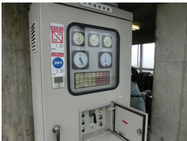
機側操作盤 外観
