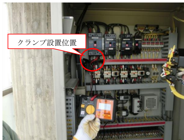
計測箇所① 動力主幹電源直下のケーブル 計測状況
