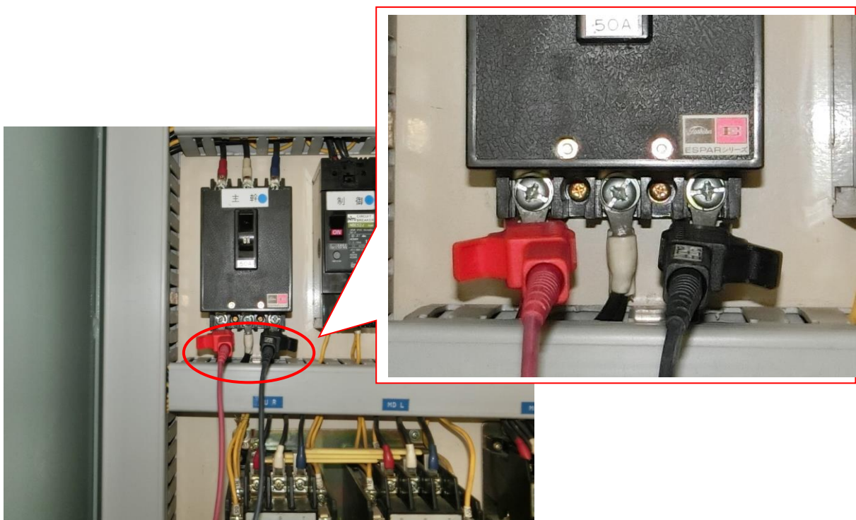
① 基準電圧の取得 動力主幹電源遮断器 端子部における取得例
