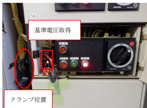
図 6-4 コントロールセンタの計測箇所（参考）
