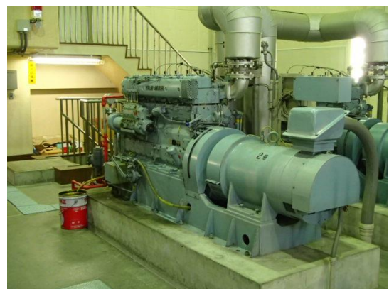
写真 1-2 自家発電機用原動機
