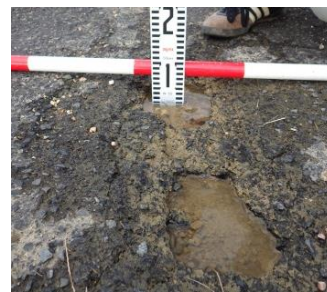
現地写真（陥没）
