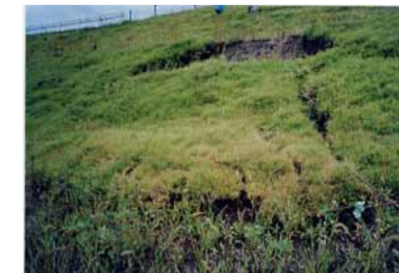
【法崩れ（H10：本川左岸 36.4km）】
