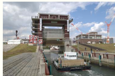
閘門及び監視装置 （整備済み）
