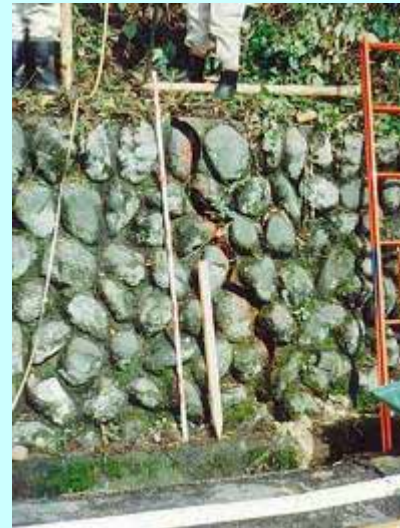
国道462号線沿いの擁壁に発生した亀裂
