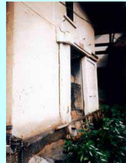
地すべり地内の民家蔵に発生した亀裂
