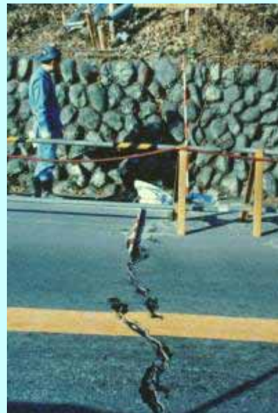
国道462号線に発生した亀裂
