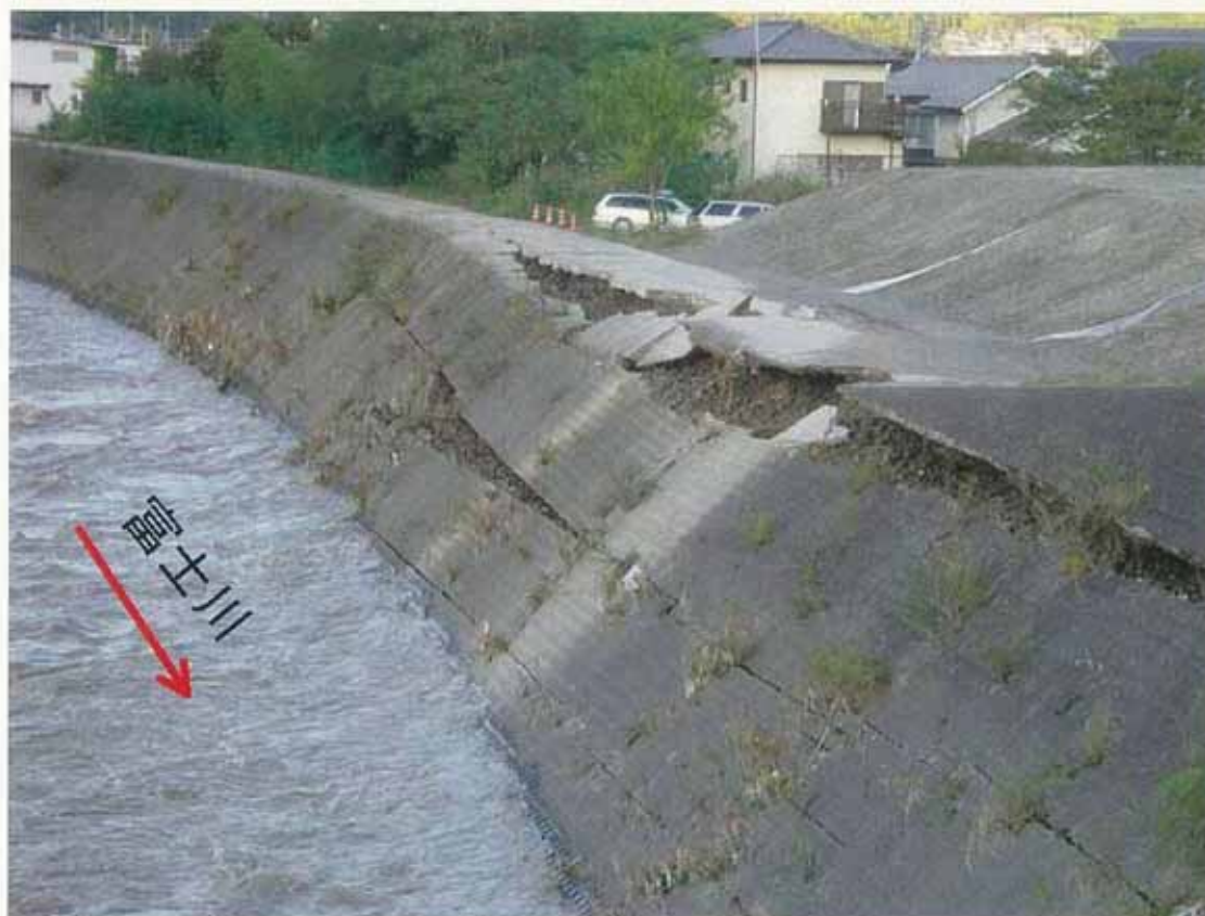
被災状況写真(平成16年10月21日発生)
