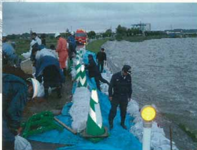
堤防法肩仮復旧状況 (北浦右岸7km付近:潮来市釜谷地先)
