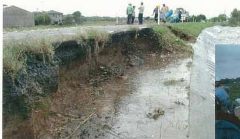
波浪による堤防法肩崩壊 (北浦右岸7km付近:潮来市釜谷地先)
