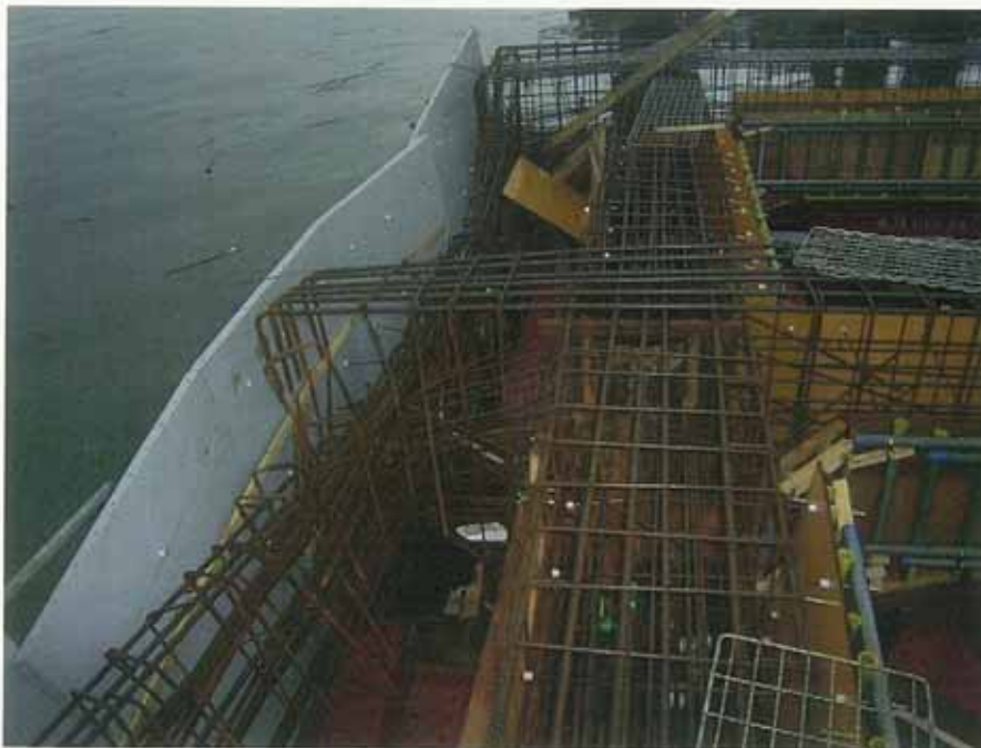
▲ 木更津南部地区岸壁（-12m）被害状況
