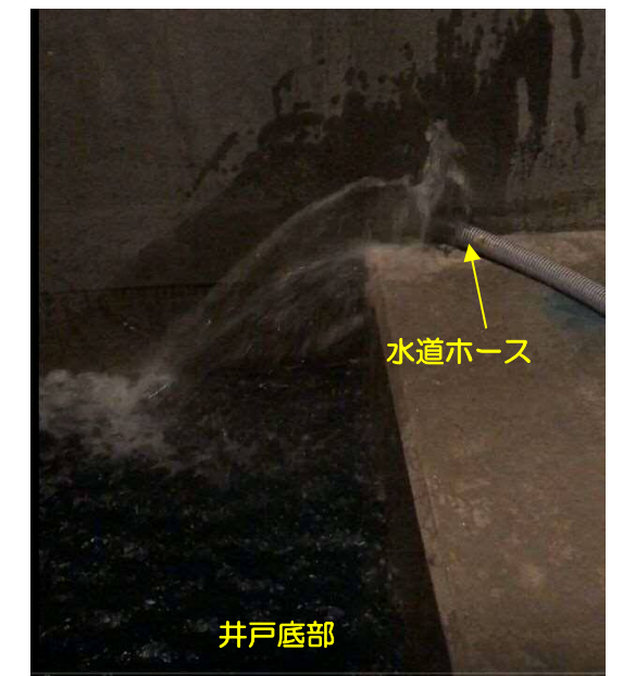
(b) 水道水による湛水
