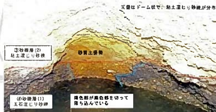
空洞①状況写真
